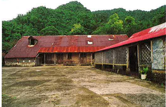
La Griyelière à Vieux Habitants. Une ancienne exploitation de café et d'épices de la Côte sous le vent, témoignage unique de l'activité agricole des siècles passés, mais aujourd'hui menacée de ruine.
